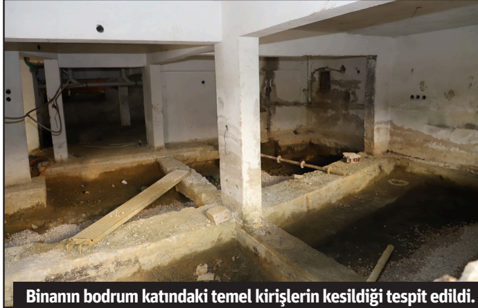
Binanın bodrum katındaki temel kirişlerin kesildiği tespit edildi.
