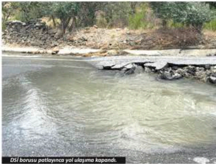
DSİ borusu patlayınca yol ulaşımına kapandı.
