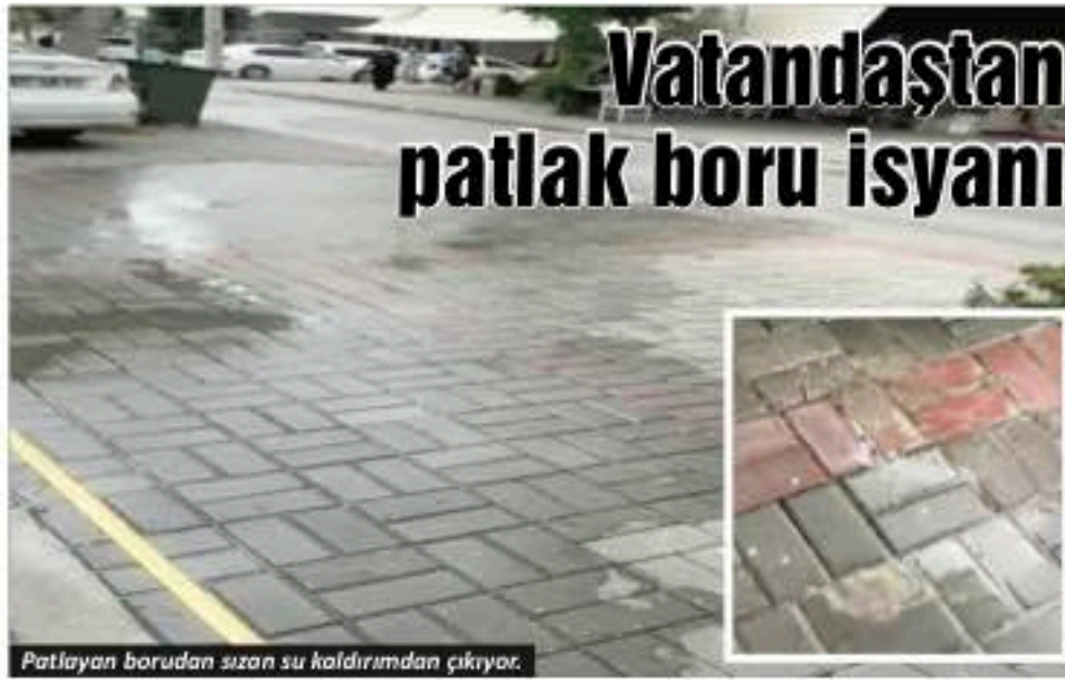
Patlayan borudan sızan su kaldırımından çıkıyor.
